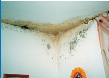
Bild 4: Schimmelpilzbefall undichtes Flachdach
