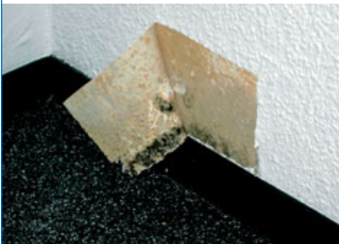
Bild 3: Schimmelpilzbefall unter der Tapete
